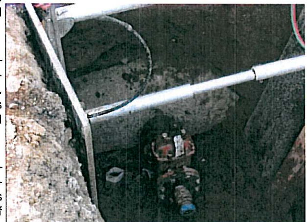
Frito Lay, CVWD
