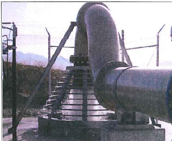
MWD Turnout CB-14
